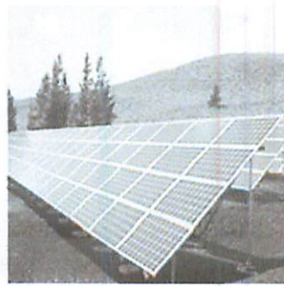
太陽光発電施設
